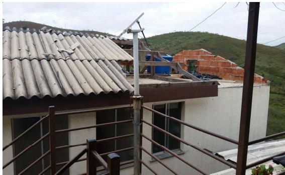
Figura 5 - Destelhamento por ação dos ventos
